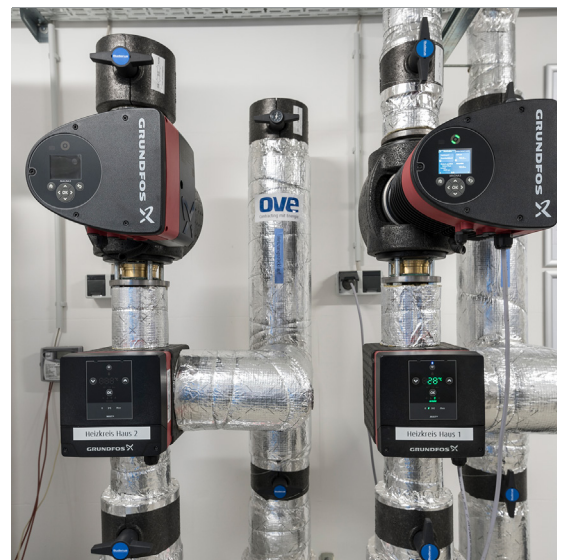
Menggroepen voor bouwphase 1 (rechts) en 2 (links), elk met MIXIT-regelmodule en secundaire MAGNA3-pomp
