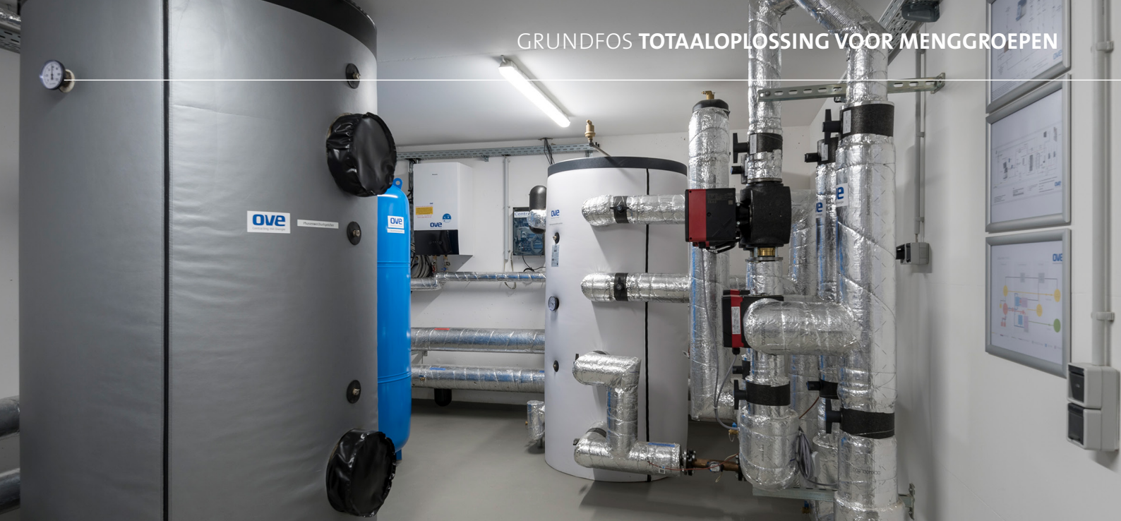
De technische ruimte voor de hele woonwijk met opslag in fase-overgang, wkk-installatie, bufferopslag, warmtepomp en menggroepen
